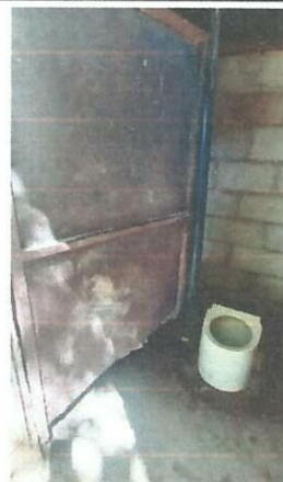
Foto 2: Condiciones actuales de las puertas, el tipo de taza plástica en malas condiciones y con el mal olor permanente por la fosa séptica.
